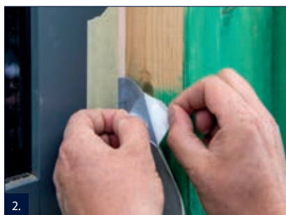
2. Při nedostatku místa lze vytvořit napojení do 15 cm nad úroveň terénu pomocí butylové pásky BD. Butylovou pásku následně celoplošně překrýt hmotou RD 2.
