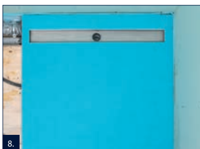
8. Seřiznout všechny vrstvy skladby s hranou sprchové desky, aby bylo možné následně navázání podlahové konstrukce.
