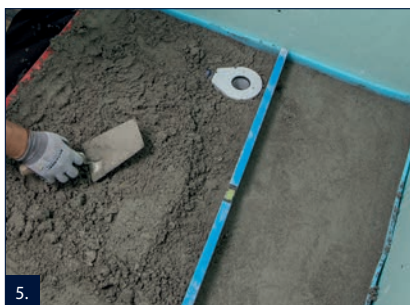
5. Na olejový papír nebo PE fólii vytvořit vodorovnou vrstvu rychlovazným potěrem M 54FM v požadované výšce.
