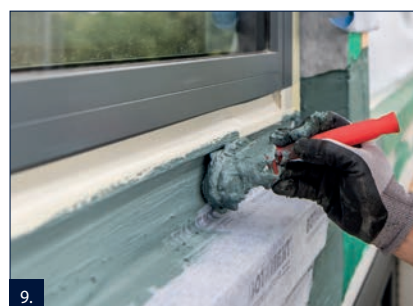
9. Následně překrýt alespoň okraje pásky PB hmotou RD 2, aby se zabránilo zatečení pod pásku.
