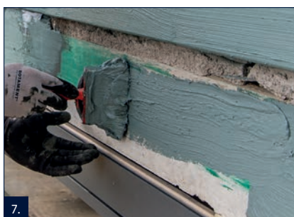
7. Na podklady, kde se bude ukládat páska PB, celoplošně nanést vrstvu hmoty RD 2 pomocí stětky nebo zubové stěrky.
