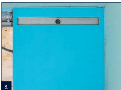
8. Seříznout všechny vrstvy skladby s hranou sprchové desky, aby bylo možné následně navázání podlahové konstrukce.
