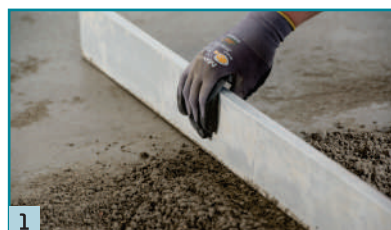
1 Po usazení okrajové pásky se na únosný podklad ukládá rychleschnoucí potěr Botament M54 FM do kontaktního můstku.
